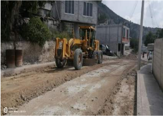
Imagen 3: Proceso de la construcción de pavimento Empedrado en calle Melesio García en la localidad Tunititlan.
