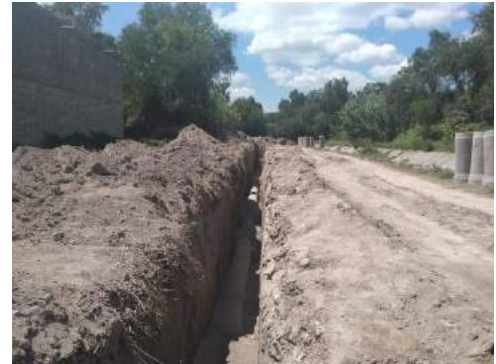
Imagen 64: Trabajos en la construcción de red de alcantarillado primera etapa para beneficiar a la localidad de Zacualoya en el municipio de Chilcuautla
