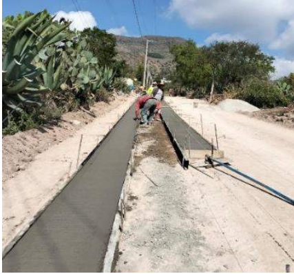
Imagen 17: Proceso de la construcción de pavimento con huellas de concreto hidráulico y empedrado asentado en seco en calle 2 de noviembre y 3 de mayo en la localidad de Huitexcalco Colonia
