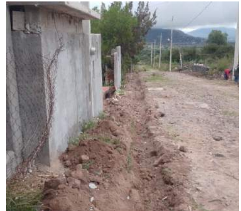
Imagen 50: Inicio de los trabajos de la construcción de guarniciones y banquetas en calle Pirules en la localidad de Huitexcalco Colonia.
