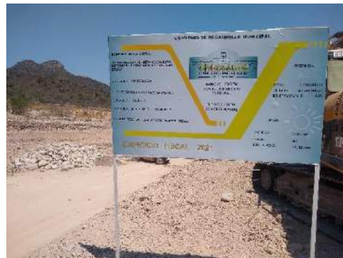
Imagen 38: Mampara Informativa de la construcción de nueva celda para disposición de residuos sólidos 1era etapa.
