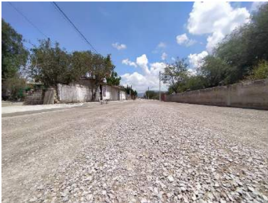
Imagen 15: Construcción de pavimento asfáltico en calle 15 de abril en la localidad de Texcatepec
