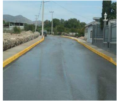
Imagen 48: Término de la construcción de guarniciones y banquetas en calle Mauricio Muñoz Basilio en la localidad de El Dadho.
