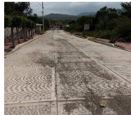
Imagen 10: Término en la construcción de pavimentación hidráulica en calle Aldama del cadenamiento 0+196.00 al 0+219.31.00 en la localidad de Tunititlan
