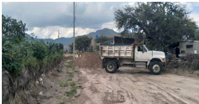
Imagen 1: Proceso de la construcción de pavimentación hidráulica y empedrado en calle San Nicolas
