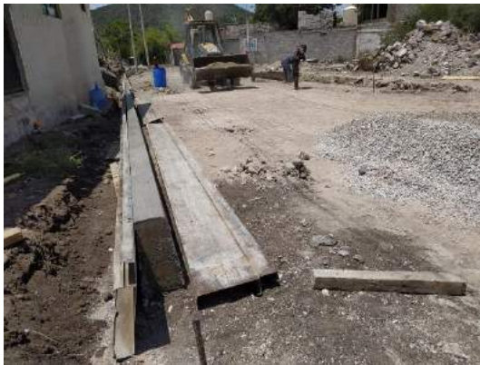
Imagen 19: Trabajos en la construcción de pavimento con huellas de concreto hidráulico y empedrado asentado en seco en calle Los Pirules en la localidad de El Cerrito
