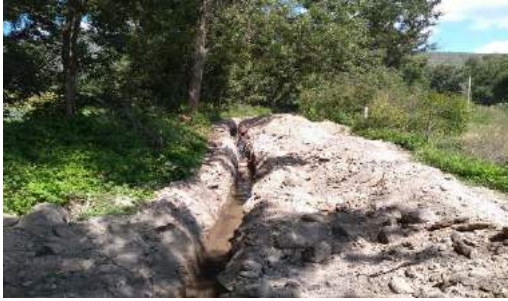
Imagen 61: Proceso en la rehabilitación del sistema de agua potable de la localidad de Tlacotlapilco.
