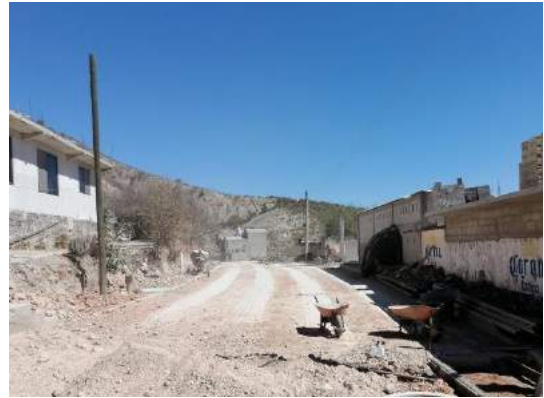
Imagen 4: Terminó de la construcción de pavimento empedrado en calle Melesio García en la localidad Tunititlan
