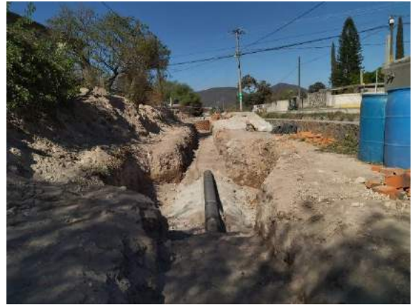
Imagen 56: Proceso de la construcción de red de drenaje sanitario en la localidad de la estancia, municipio de Chilcuautla, hgo. (etapa 1 de 5)
