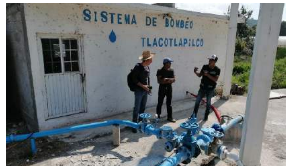
Imagen 60: Visita de obra (proceso de licitación) para la Rehabilitación del SAP Tlacotalpilco, con personal de la CEAA, Delegado, Comité de obra y operador del
