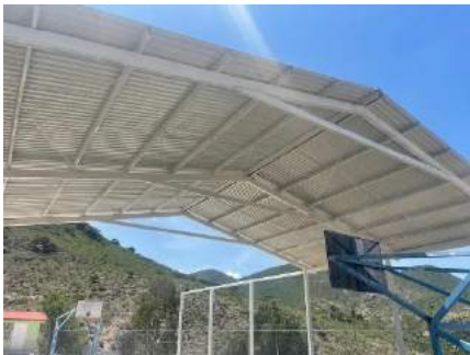
Imagen 29: Construcción de techado en área de impartición de educación física en escuela primaria bilingüe Adolfo López Mateos C.C.T. 13DPB0158Z de la localidad de El Boxaxni (tercera etapa)
