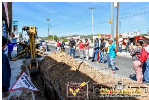
Imagen 57: Construcción de sistema de alcantarillado sanitario de la localidad de Xothi, Chilcuautla, etapa dos de cinco (aportación municipal)
